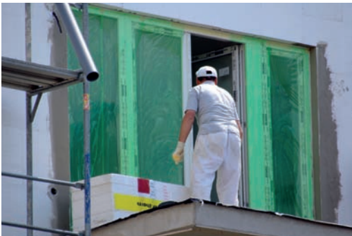
Sanierungen beeinflussen die Dichtheit der Gebäudehülle.
